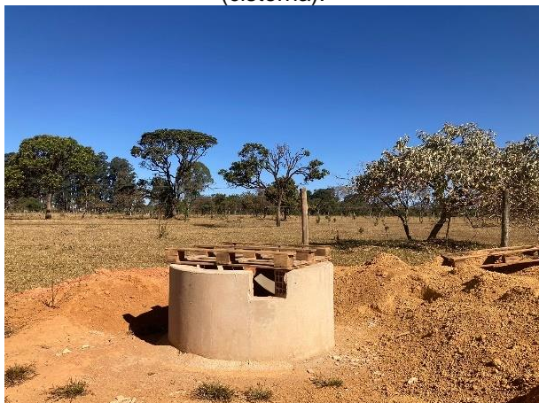
Figura 09: Vista de um dos pontos de captação (cisterna).
