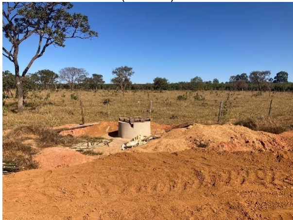
Figura 12: Vista de um dos pontos de captação (cisterna).
