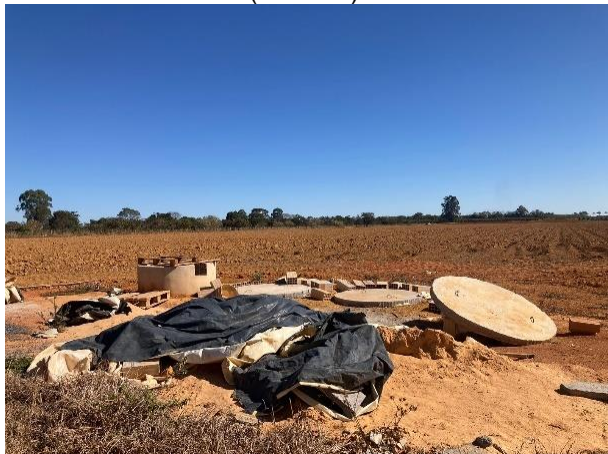
Figura 11: Vista de um dos pontos de captação (cisterna).
