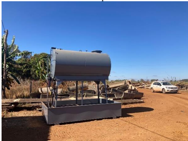
Figura 18: Vista do ponto de abastecimento com contenção.
